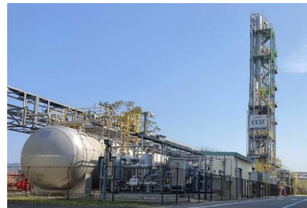
（清掃工場内のCO 2 分離回収設備）
