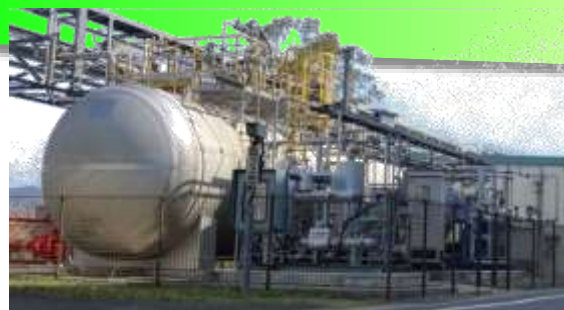
二酸化炭素貯留タンク
