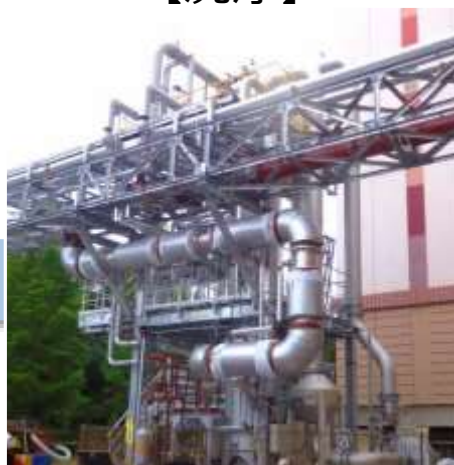
排ガスコンディショニング装置
