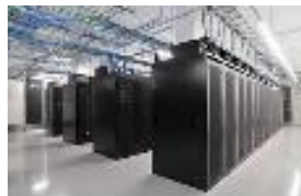
データセンター
