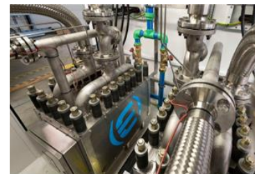
水素製造装置
