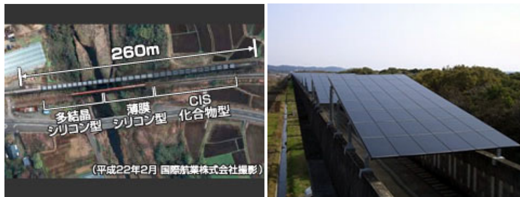
▲都農第一・第二発電所／出所：宮崎ソーラーウェイ株式会社
