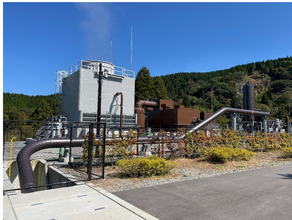
▲南阿蘇湯の谷地熱発電所
