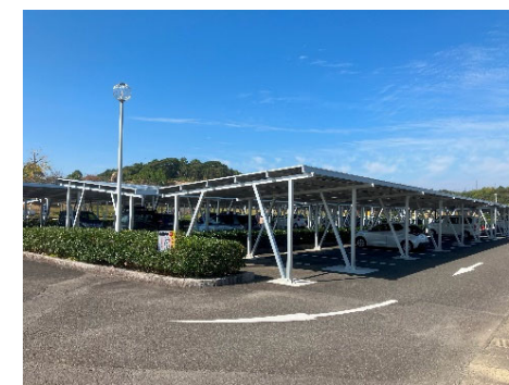
▶ 駐車場を活用した太陽光パネル
