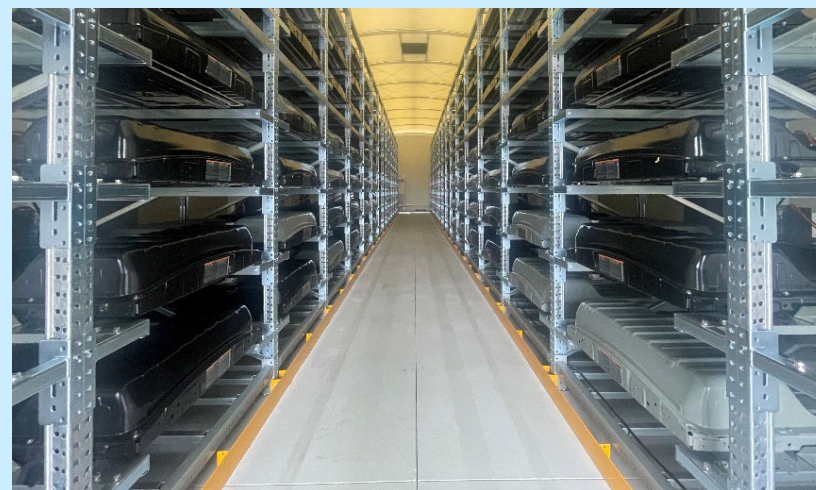
でんきの駅川尻 内観 ※でんきの駅合同会社提供資料
