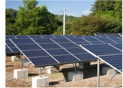
太陽光発電設備
