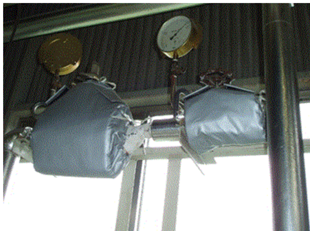
配管・バルブの断熱保温
