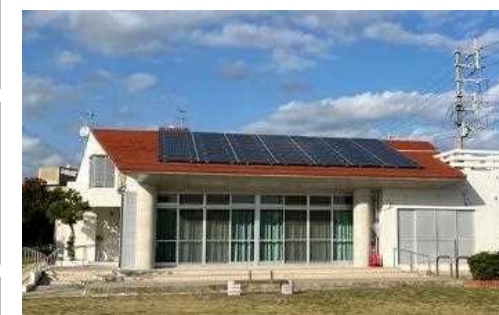
公共施設への太陽光パネルと蓄電池の設置
