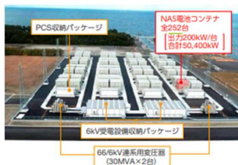
大容量蓄電システムを備えた「豊前蓄電池変電所」全景
