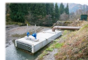
小水力発電施設
