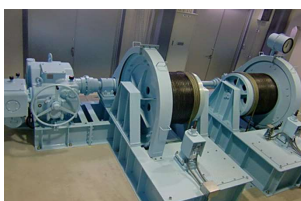
水門等の開閉器
