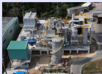
新設したバイオマスボイラー
