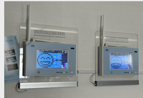
電気の使用状況が分かるモニター付きデマンド警報器
