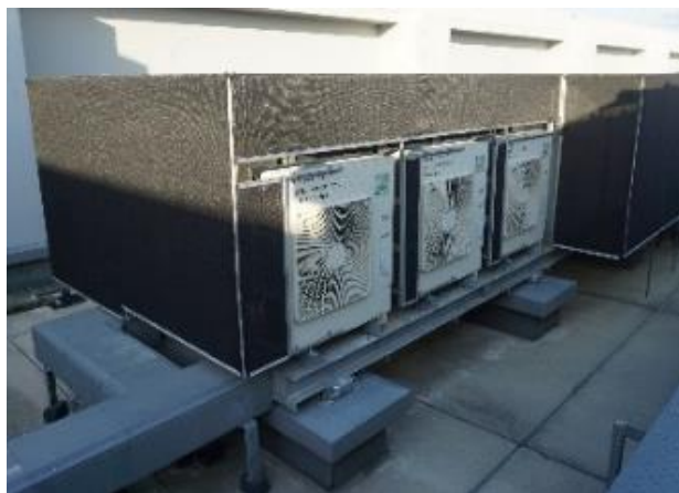
【提案制度事例：IP 工場屋上の空調室外機】 遮光用のシートで覆うことで省エネ効果を確認。横展開で鳥栖工場でも導入。
