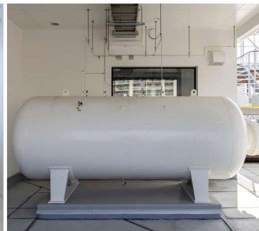
屋上設置の水素タンク
