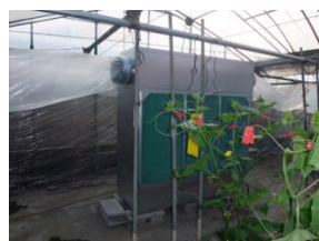
〔 温室内に設置し、稼働中の除湿ユニット 〕
