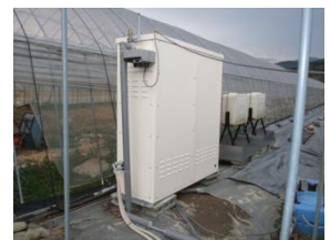
〔 温室外に設置した調湿液濃度再生ユニット 〕
