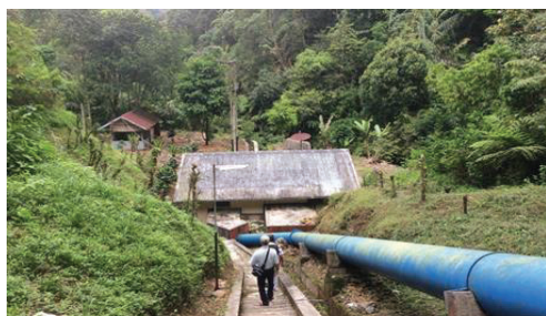
インドネシアの水力発電設備
