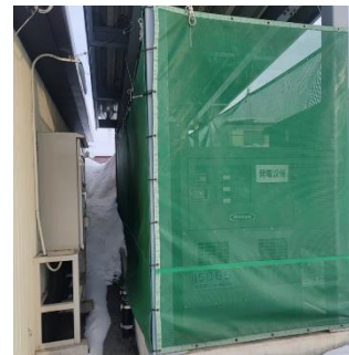
導入した非常用自家発電機
