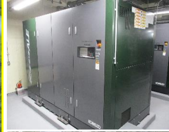
コンプレッサー/ドライヤー
