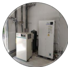
水素発生装置付帯設備
