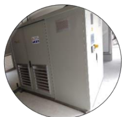
水素発生装置
