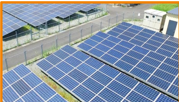
イワテック第一ソーラー 1MW
