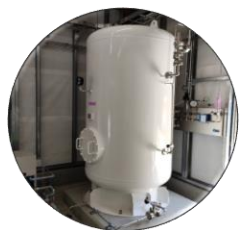
水素バッファタンク
