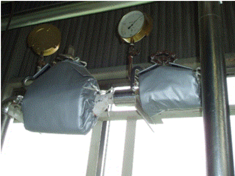
配管・バルブの断熱保温
