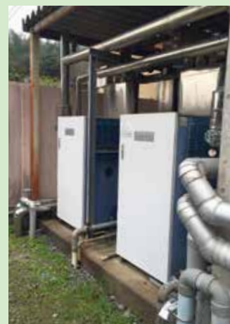
給湯用ボイラー (更新前)
