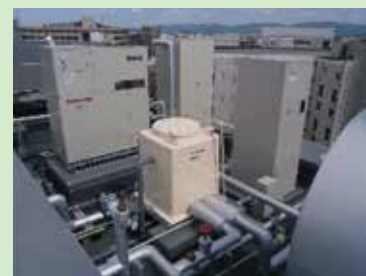
ハイブリッド給湯設備
