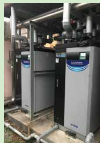
給湯用ボイラー (更新後)
