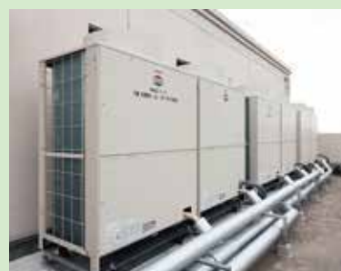
省エネ性能の高い個別空調システムの室外機
