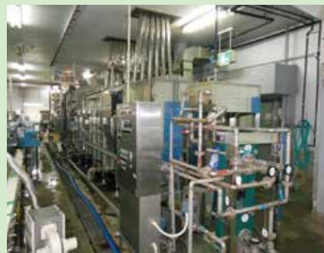
更新後の自動蒸麺装置
