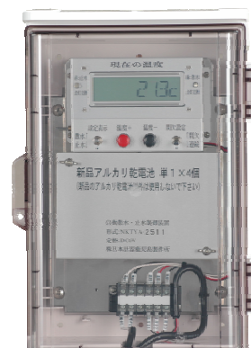
自動散水・止水制御装置
